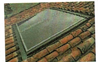
Panneaux solaires encastrés dans le plan de toiture
