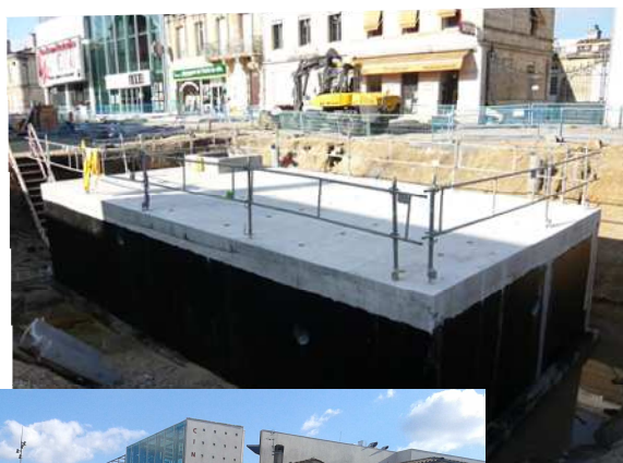
Place de la Ve République et sa fontaine sèche (jets et brumisation). Réservoir de 50 m3 d'eau recyclée et traitée
